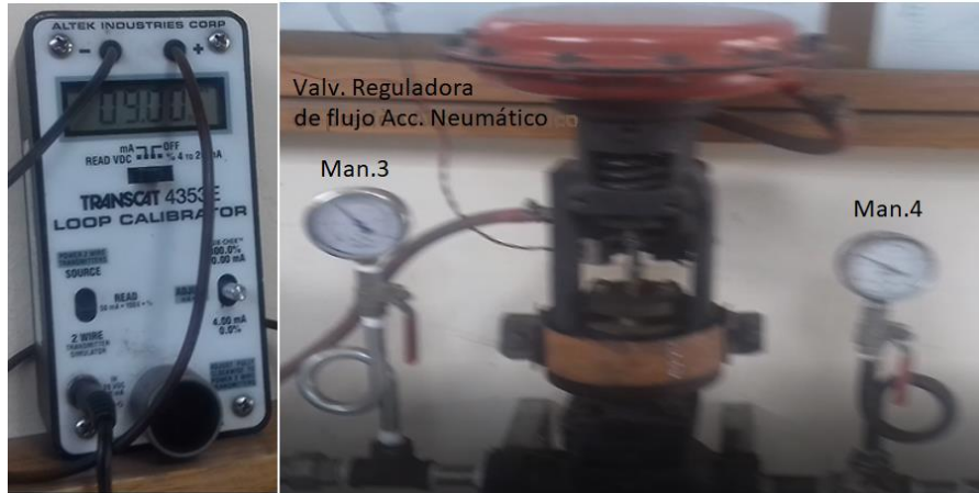
Figura 73. Generador de señales y manómetros 3 y 4 de la válvula reguladora de flujo.
