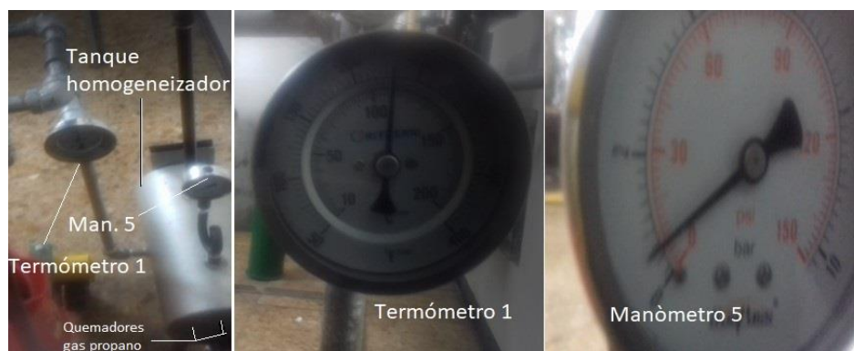
Figura 75. Tanque homogeneizador con manómetro y medidor de temperatura.
