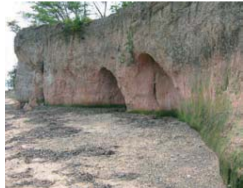
Figura 9. Proceso erosivo dentro del primer nivel de terraza.
