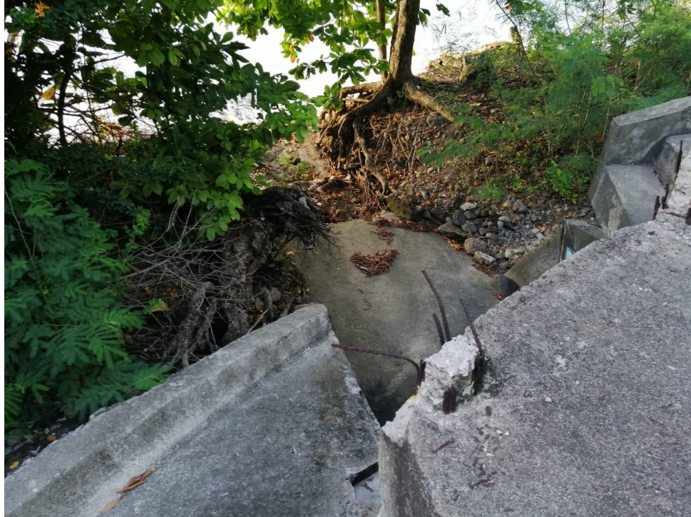
Imagen 6. Box culvert en Hoy's Hill, donde se aprecia el deterioro en la estructura de la carretera causado por erosión del suelo por escorrentías.
