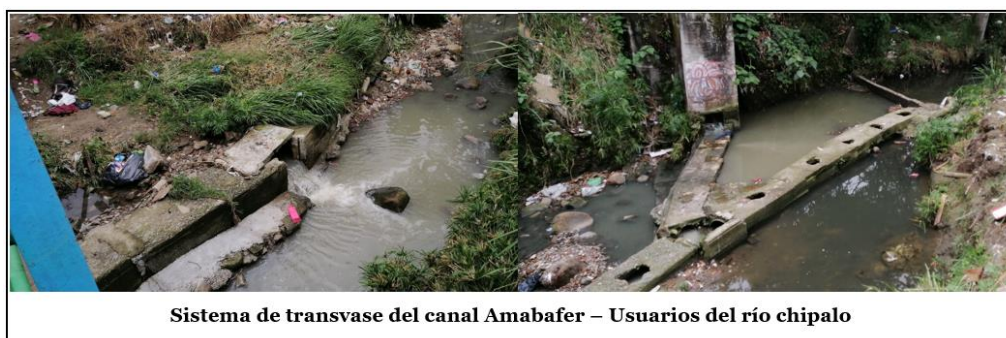
Figura 6-13 Sistemas de captación y conducción de aguas para uso agrícola – río Chipalo
