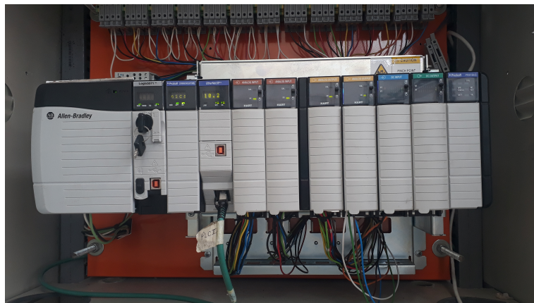
Figura B-1.: PLC Allen Bradley de la planta LISC.
