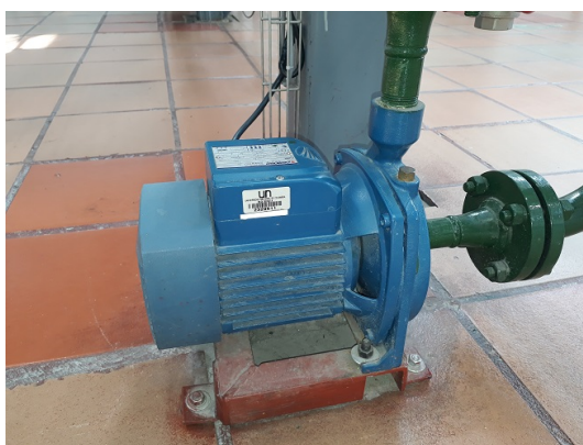
Figura A-20.: Bomba centrífuga P-01.
