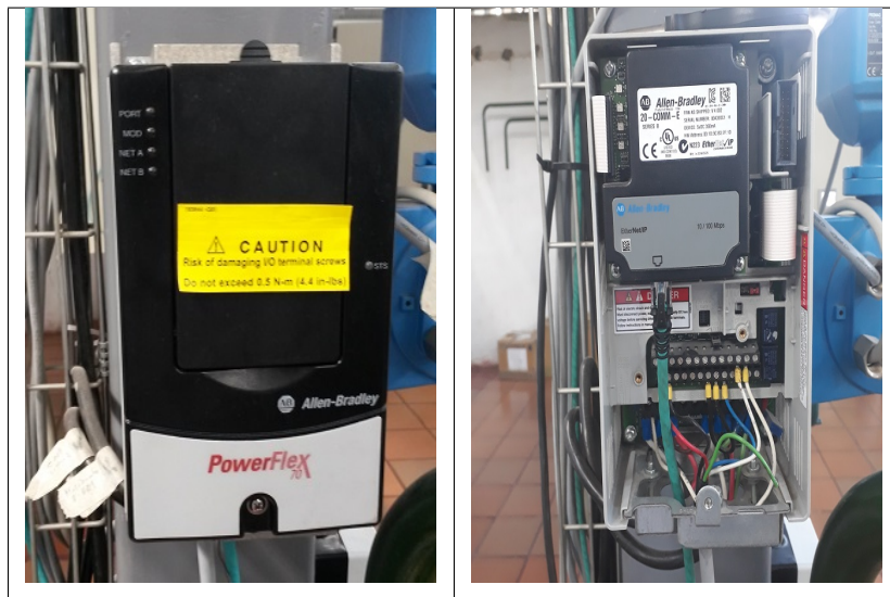
Figura A-21.: Variador de frecuencia de la bomba P-01.
