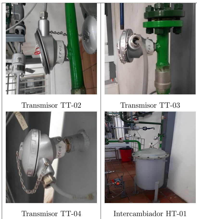
Figura A-10.: Transmisores de temperatura del intercambiador HT-01.
