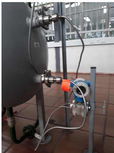
Figura A-6.: Transmisor de nivel PDIT-01.
