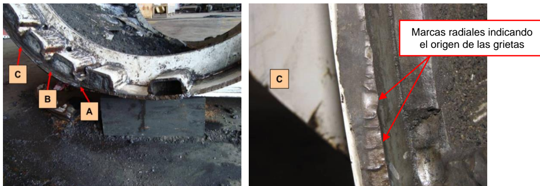
Figura 2-25: Grietas de fatiga en parte interna - Junta anillo-metal base.
