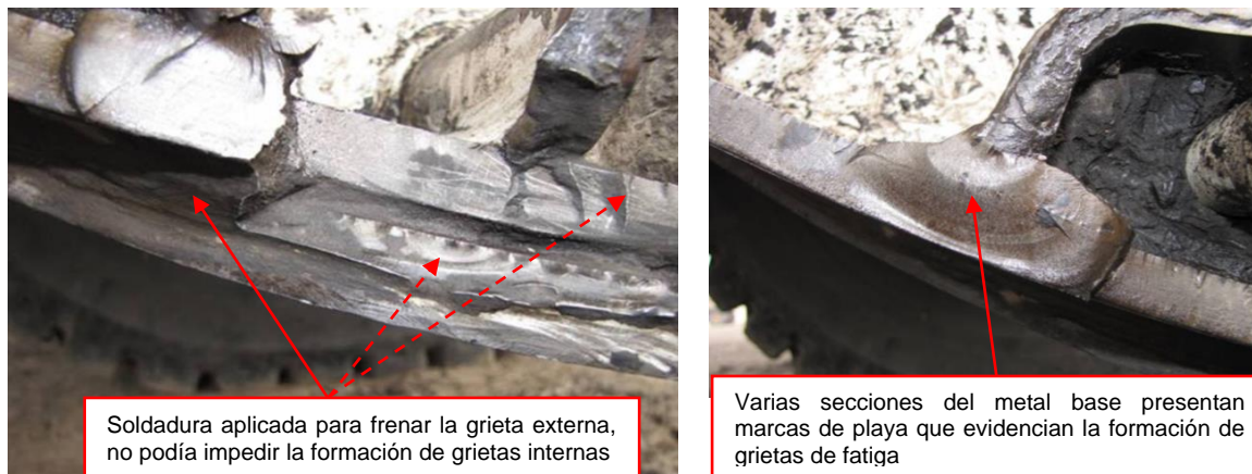
Figura 2-27: Grietas de fatiga en parte interna - Junta anillo-metal base-Nose cone.
