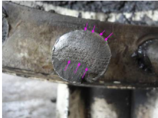
Figura 2-38: Marcas de playa en perno ubicado en zona baja de “Housing”.
