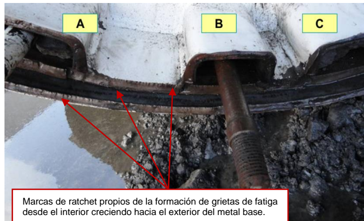
Figura 2-29: Grietas de fatiga en parte interna - Junta Anillo-Metal base-Nose cone.
