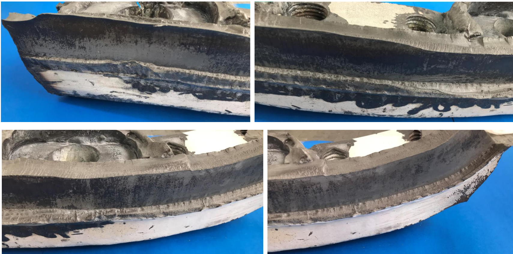
Fotografía E-1: Detalles cordón de soldadura fracturado.
