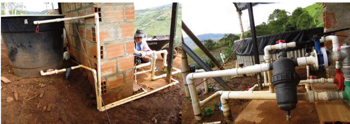
Figura 9. A) Tanque para la mezcla de la solución nutritiva. B) Tubería principal del sistema para fertirriego y riego por goteo
