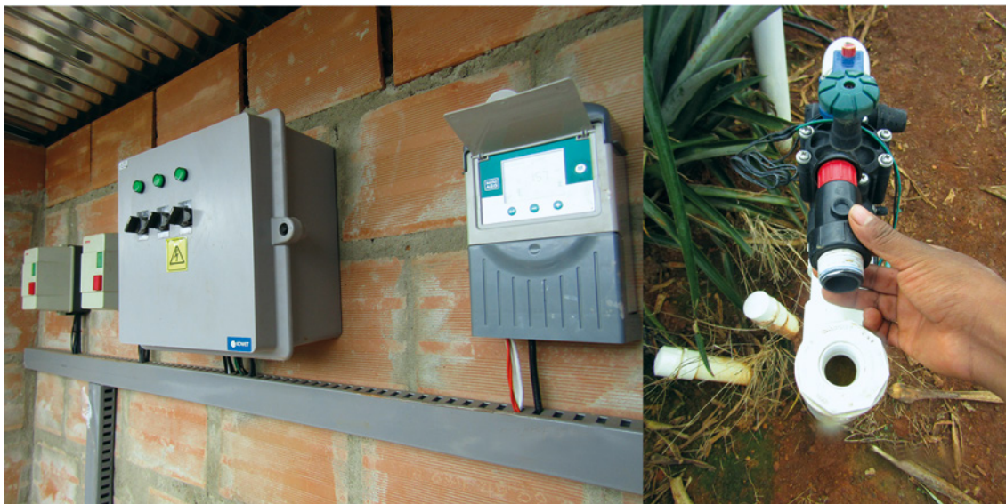
Figura 7. A) Panel de control automatizado para aplicación del riego por goteo. B) Módulo de riego en cada subparcela con la tecnología
