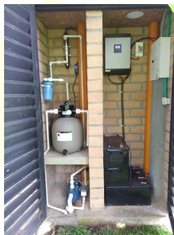
Figura 6. Sistemas de iluminación y energía solar; potabilizador de aguas lluvia de V2.
