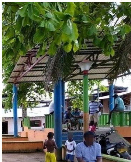
Figura 7-3: Estructura en la plaza central del pueblo, manzana que presentaría 100% de colapso..
