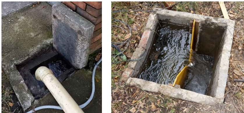
Fotografía 2-20 y Fotografía 2-21: Caja de inspección y caja de medición de caudal con vertedero triangular de pared delgada.
