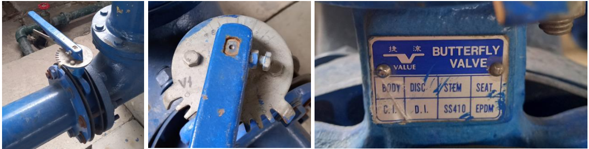
Fotografía 2-14, Fotografía 2-15 y Fotografía 2-16: Válvula de mariposa (VALV 1) en la descarga del sistema de bombeo.
