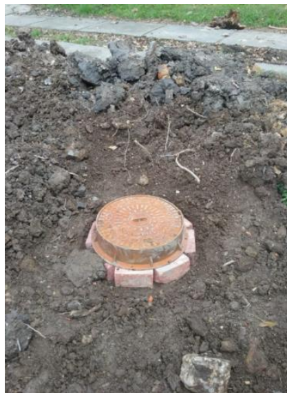
Fotografía 2-11: Ducto de inspección con tapa en hierro dúctil.
