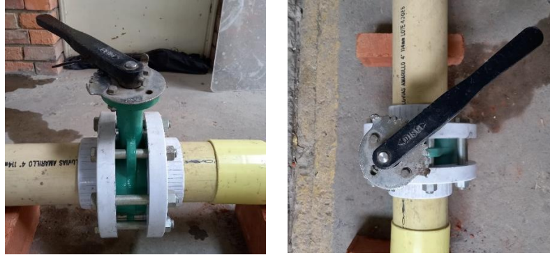
Fotografía 2-18 y Fotografía 2-19 Válvula de mariposa (VALV 2) en la tubería que entrega el agua al tanque de detención.
