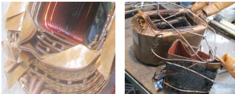
Figura 6-4: Fallas en transformadores inmersos en aceite
