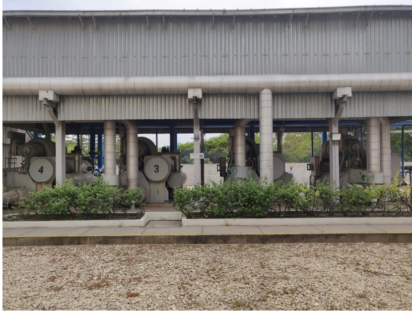
(a) Enfriadores de agua
