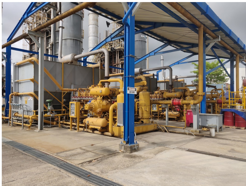
Figura 3-3.: Compresores de gas natural - Central de generación Proeléctrica.
