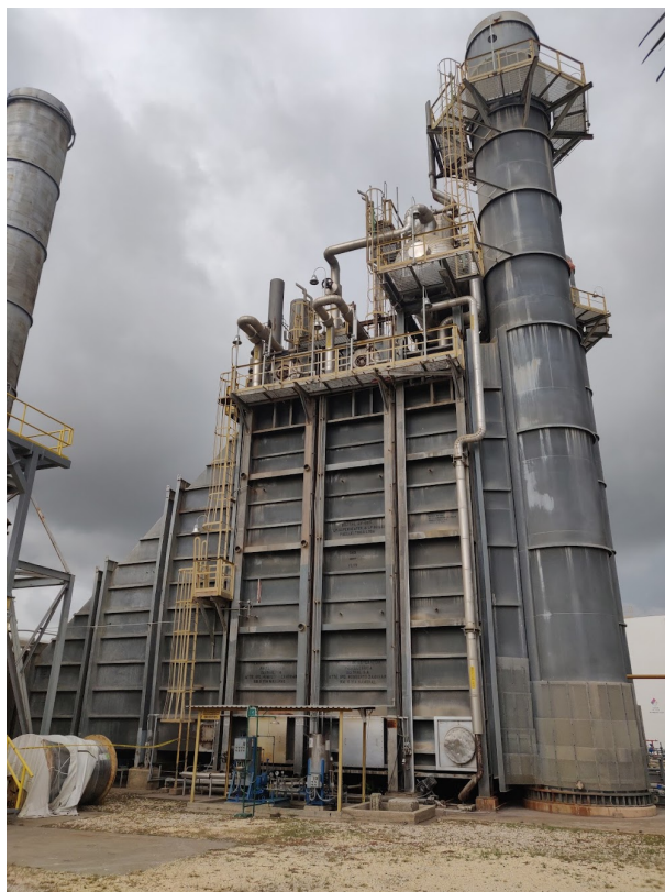
Figura 3-7.: Caldera de recuperación - Central de generación Proeléctrica.
