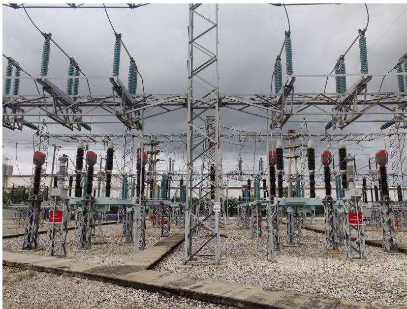
Figura 3-8.: Subestación - Central de generación Proeléctrica.
