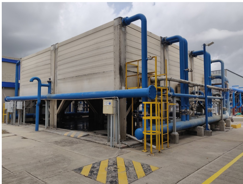
Figura 3-5.: Torres de enfriamiento - Central de generación Proeléctrica.
