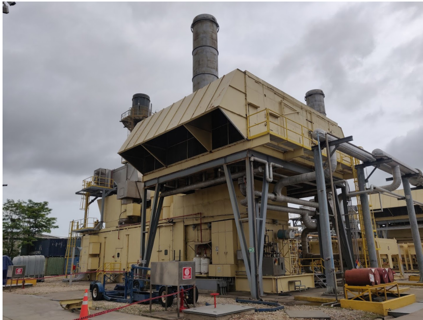
(b) Casa de filtros - Turbina LM5000
