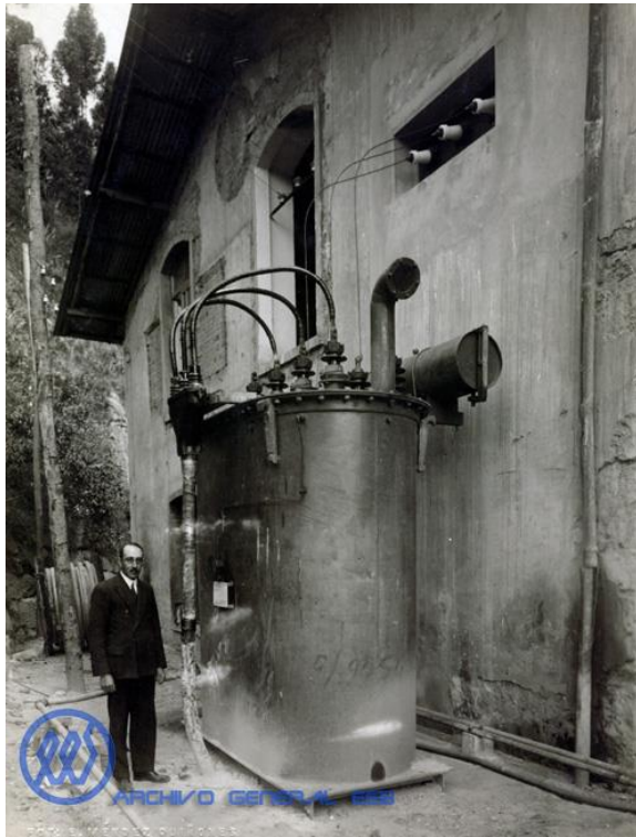
Transformador de 500 Kw en la planta de generación de El Charquito (s.f.). Archivo General EEB. Fuente: Grupo de Energía de Bogotá .
