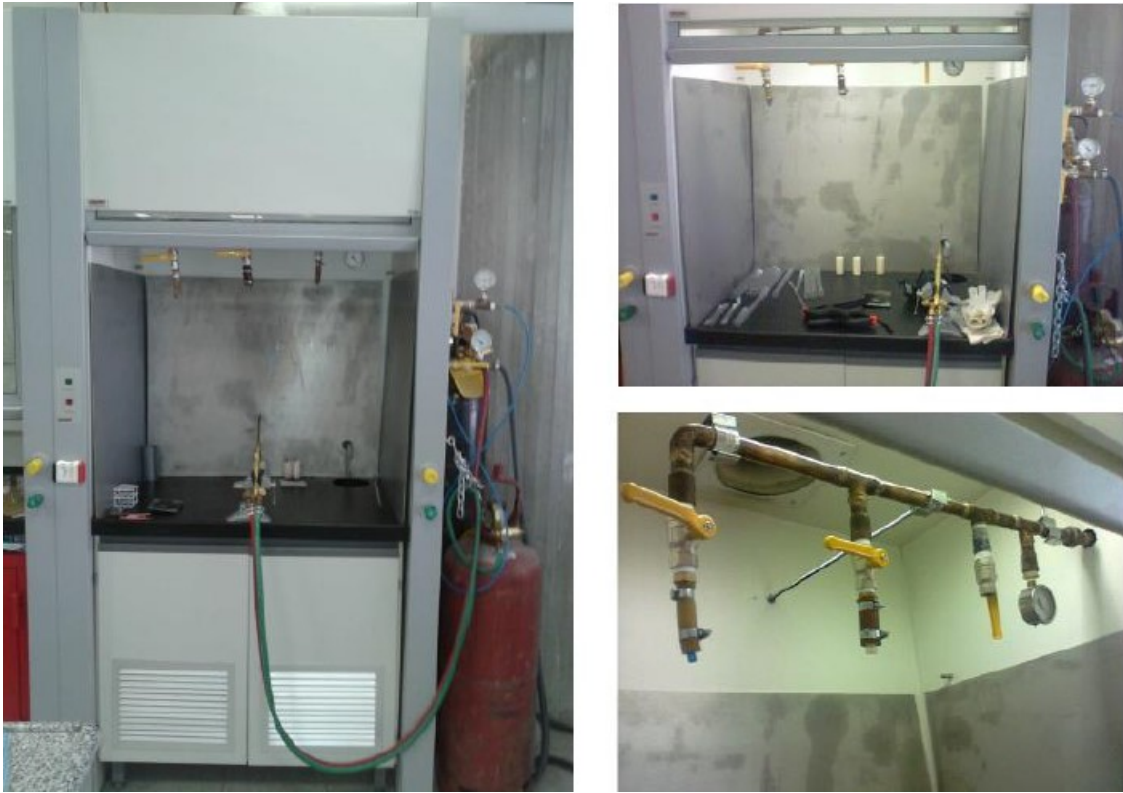
Figura 3.7. Ejemplo de estación adaptada con paredes de acero inoxidable, línea de cobre con sus respectivas válvulas, mangueras y manómetros. Imagen cortesía del profesor Michael Cabrera Báez de la UFPE de Brasil.
