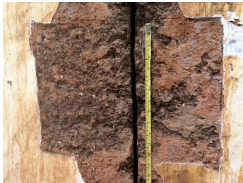
Figura 469. Gravillas visibles en un muro de tapia pisada, caso 13.
