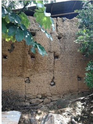
Figura 467. Mechinales en muro de tapia pisada, caso 11.
