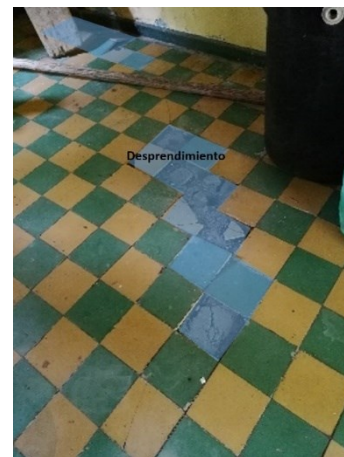
Figura 722. Desprendimiento de baldosas de piso, caso 7.
