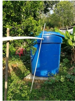
Figura 755. Tanque de distribución ubicado a mayor altura.
