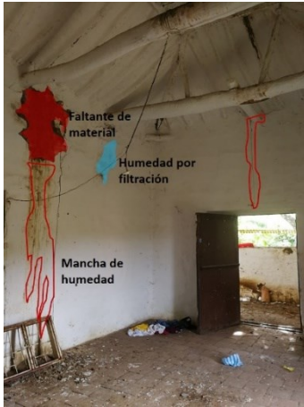
Figura 699. Lesiones puntuales en muro de tapia pisada, caso 13.
