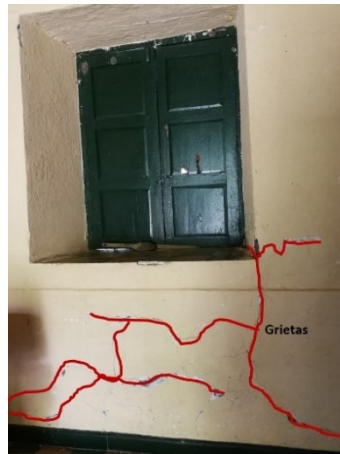
Figura 696. Grietas en sobrecimiento y antepecho de ventana, caso 7.
