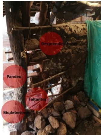
Figura 703. Lesiones graves en muro de bahareque a causa del intemperismo, caso 16.
