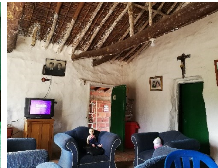
Figura 337. Redes eléctricas sobrepuestas por muros y estructuras de cubierta.
