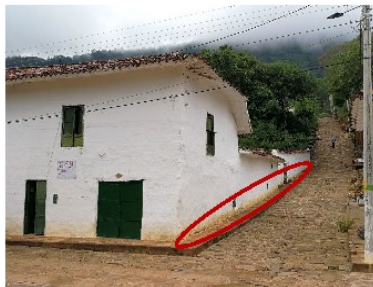
Figura 694. Tapia pisada con erosión física en sobrecimiento, caso 20.
