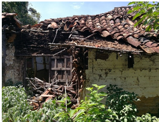
Figura 713. Faltante de tejas por retiro de sección de techo, caso 13.
