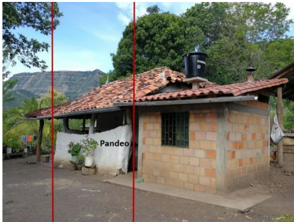
Figura 701. Pandeo de muro de bahareque, caso 2.
