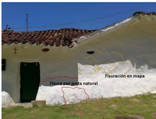
Figura 719. Fisuras por junta natural y fisuración en mapa sobre pañetes y pinturas de fachada, caso 18.
