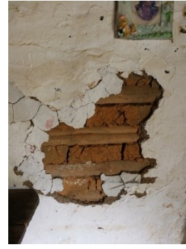
Figura 641. Pañete delgado sobre muro bahareque.
