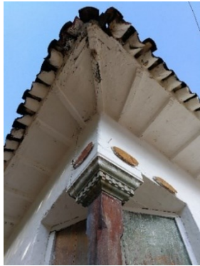
Figura 603. Esquina abierta en muros de tapia pisada.
