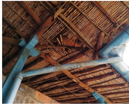
Figura 89. Sistema de canales y bajantes de aguas lluvias en el patio central, caso 11.
