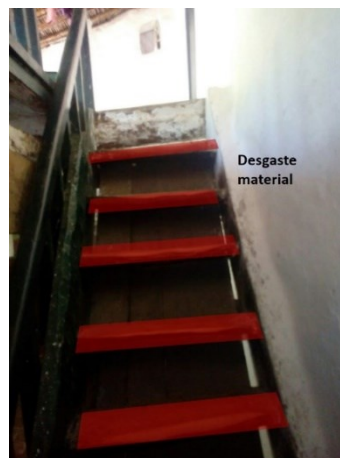
Figura 711. Desgaste de peldaños en escalera de madera, caso 20.
