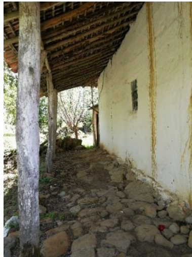
Figura 135. Edificación autoconstruida hace 63 años, hoy abandonada, caso 9.
