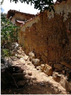
Figura 456. Sobrecimiento en muro externo, caso 11.
