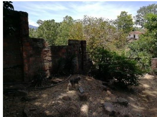
Figura 60. Cercado y muros dentro de la ronda de la quebrada La Puya, caso 11.
