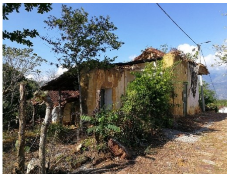
Figura 758. Edificación en ruina producto del abandono.
