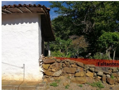
Figura 704. Faltante de piedras de coronamiento en cercado, caso 17.
