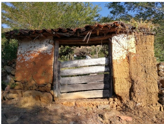
Figura 718. Portal de tapia a punto de colapsar, caso 23.
