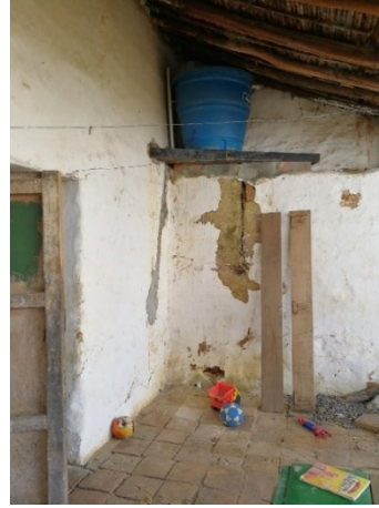
Figura 95. Tanque instalado bajo techo.
