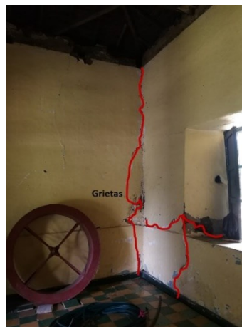
Figura 698. Grietas esquineras en muro de tapia pisada, caso 7.
