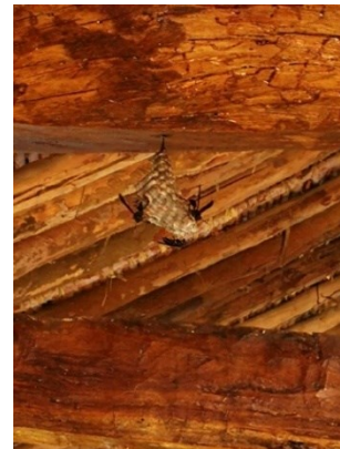
Figura 716. Nido de avispas en el telar de la cubierta.
