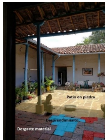
Figura 721. Lesiones en revestimiento de pisos de arcilla y piedra, caso 11.
