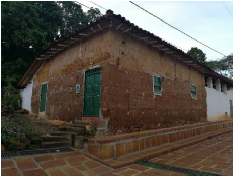
Figura 372. Fachada desprovista de pañetes, caso 14.
