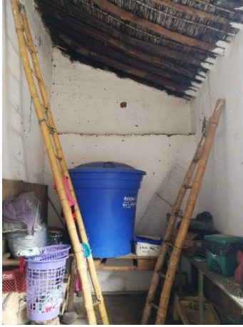
Figura 94. Tanque de reserva sobre plataforma, caso 11.
