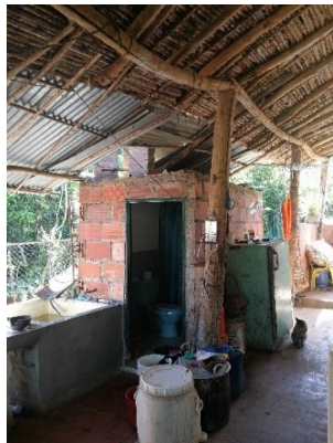
Figura 312. Unidad sanitaria bajo prolongación de galería, caso 8.
