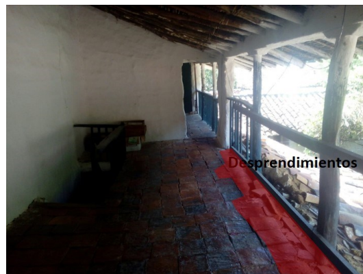
Figura 708. Desprendimiento de tabloncillos de arcilla sobre entrepiso de madera, caso 20.
