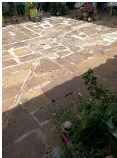
Figura 62. Drenaje de aguas lluvias desde el patio central, caso 11.
