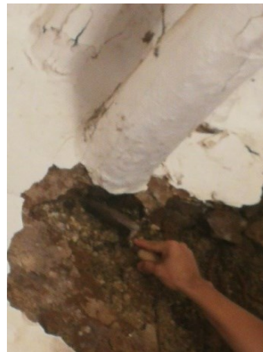
Figura 473. Solera de madera embebida en el cabezal del muro de tapia, caso 13.
