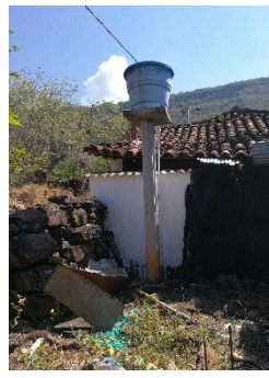
Figura 92. Tanque aéreo y baño sobre la fachada, caso 18.
