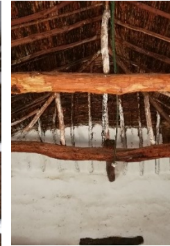
Figura 517. Tirante transversal en muro testero, caso 1.
