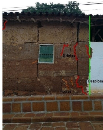
Figura 697. Fisuras, grietas y pandeo en muro de tapia pisada, caso 14.
