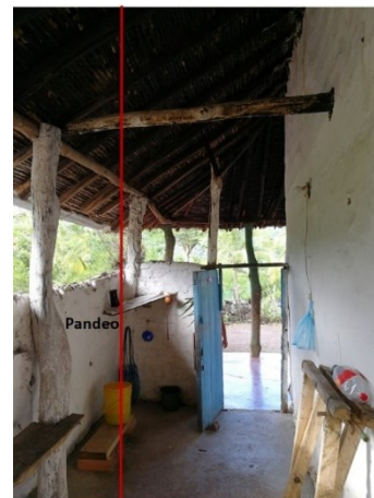
Figura 702. Pandeo de muro de bahareque, vista interior, caso 2.
