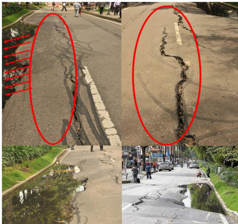
Fotografía 8-4: Estado de las vías después de la falla de la excavación.
