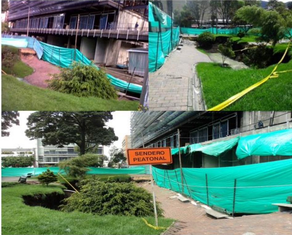
Fotografía 8-5: Estado del parque sobre la Calle 98.
