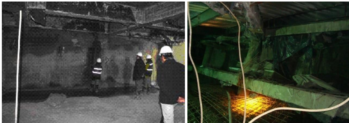
Fotografía 8-3: Compromiso estructural de elementos de pantalla y columnas.
