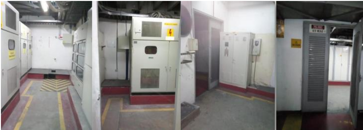
Ilustración 14. Subestaciones eléctricas C.C. Fuente: Centro comercial Cafam Floresta.
