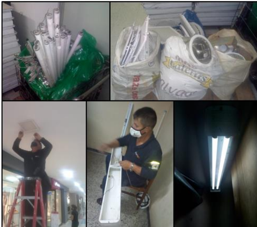
Ilustración 48. Acciones de mantenimiento programado.
