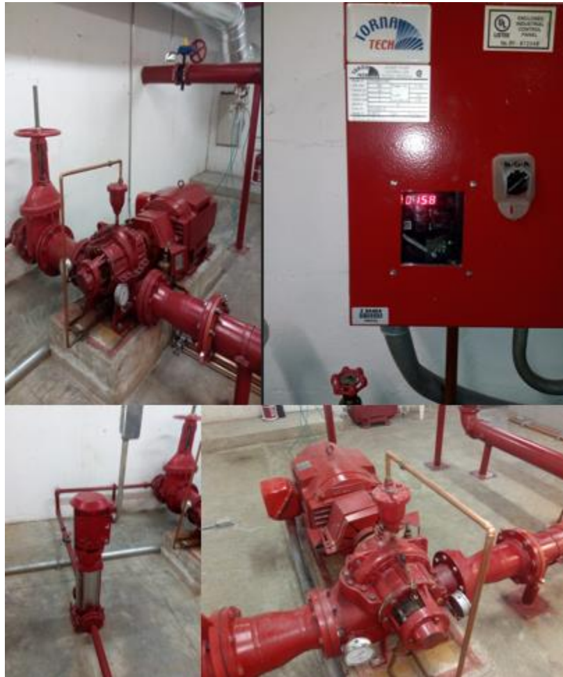
Ilustración 22. Red contraincendios. Fuente: centro comercial Cafam Floresta.
