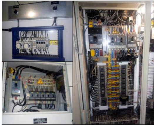
Ilustración 57. Sistema control iluminación zona común luminarias elevadas.
