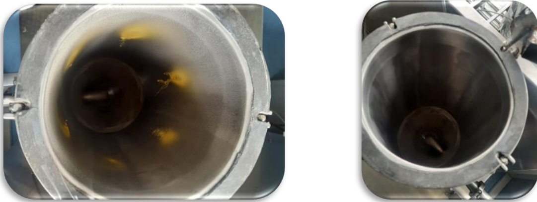
Figura 9: Limpieza cámara de mezcla.
