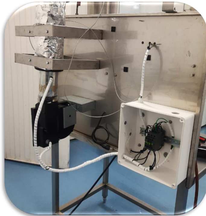
Figura 16: Tablero de fuerza secador por aspersión.
