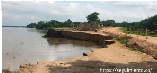
Amenaza de erosión por las dinámicas del río para la conectividad vial de El Piñón con Pivijay, Concordia, Cerro de San Antonio.
