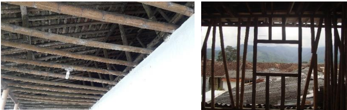
A la izquierda se ve la estructura de la cubierta con la escalera sobre el remate del muro. A la derecha la estructura del muro de bahareque. Vereda El Tigre, Salamina. Fuente: JM Sarmiento.
