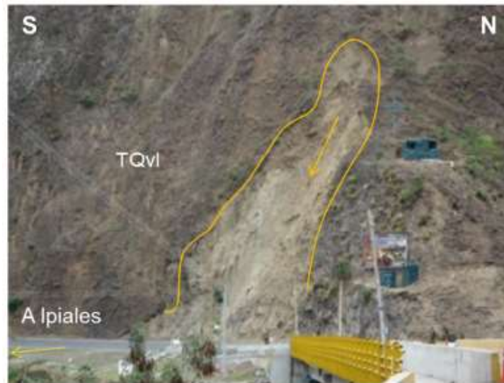
Figura 1-33: Desprendimiento de detritos en TQvl a la altura del K2+800.
