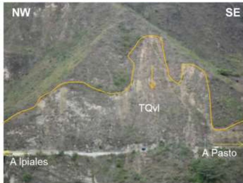
Figura 1-34: Erosión superficial en rocas de la unida TQVI en K2+960.
