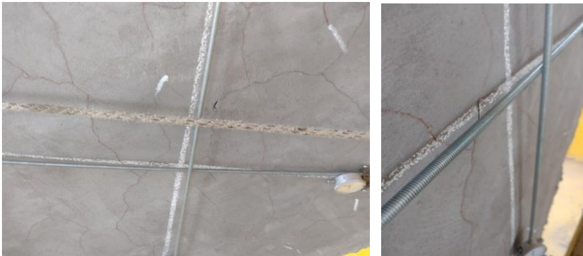
Figura 4-27. Fisuración en el recubrimiento del muro Mt-R1L-1
