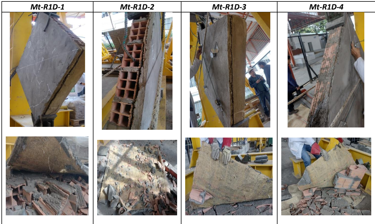
Figura 4-21. Desprendimiento de la capa de refuerzo en los muros Mt-R1D
