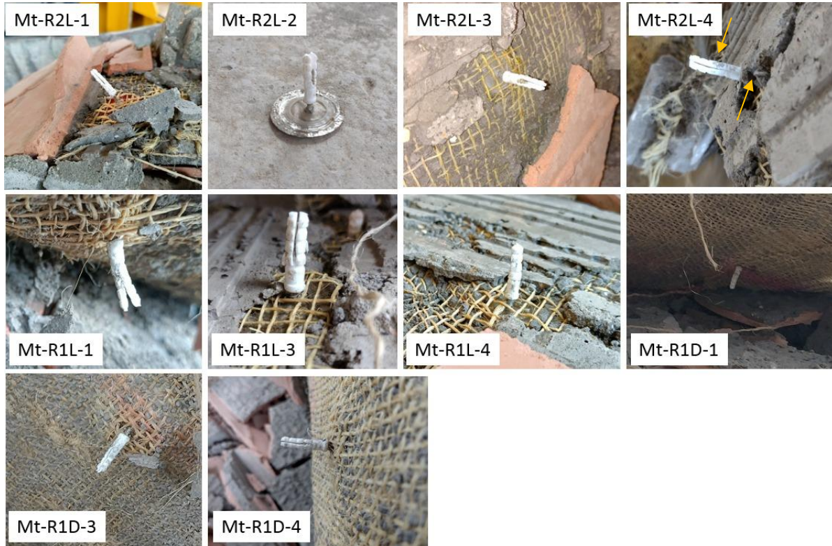
Figura 4-32. Falla por cortante generada en los conectores
