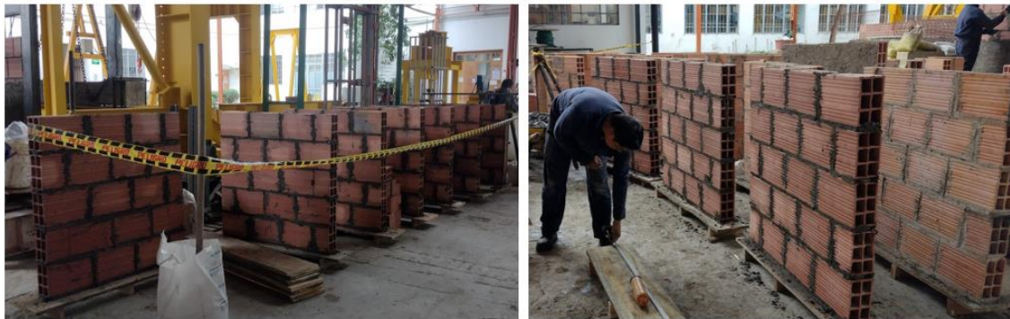
Figura 3-38. Muros de mampostería sin reforzamiento
