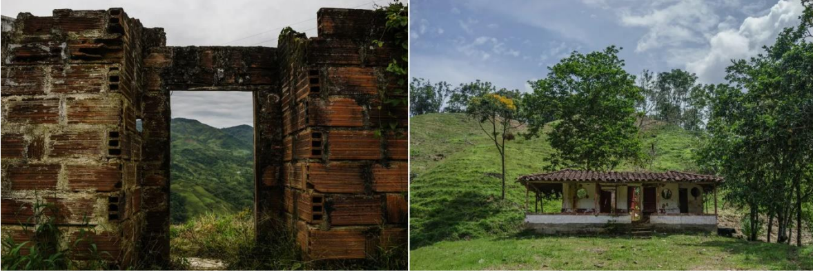
Fotografía 25: Condición deteriorada de algunas viviendas después del retorno a la vereda El Topacio Fuente: Tomada por Mauricio Montoya Sánchez. 14 de Abril del 2023.
