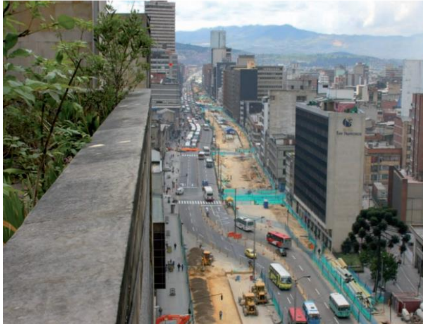
Ilustración 21. Una avenida urbana debe tener la capacidad de renovarse, de actualizarse, manteniendo su forma. Imágenes tomadas de: Niño, C. Et al. (2010). La carrera de la modernidad. Construcción de la carrera decima (1945-1960). Alcaldía Mayor: Instituto distrital de cultura y turismo.
