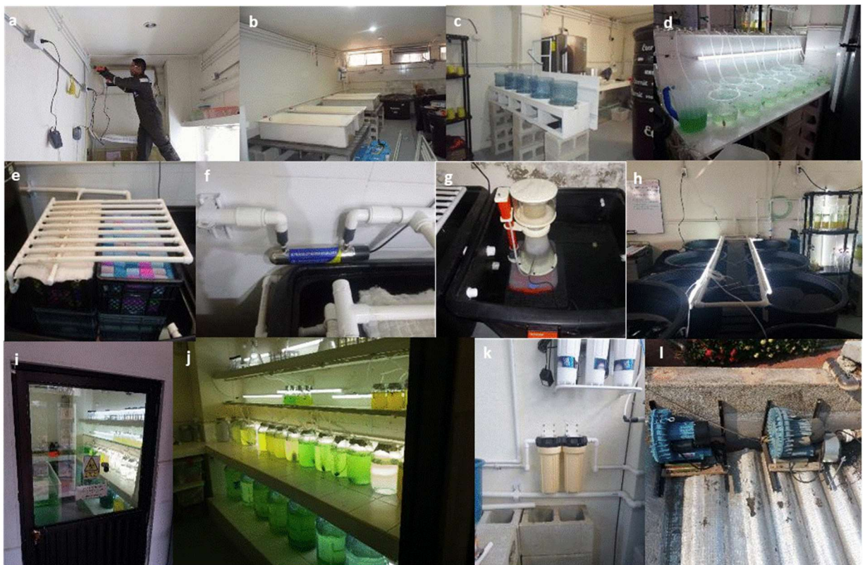
Figura 1 - 2: Montajes detallados en el AcuiLab. Tuberías primarias y secundarias (a), área de reproductores de jaiba azul (b), cultivo de rotíferos (c), zona para desarrollo de ensayos de larvicultura (d), filtro biológico (e), luces ultravioletas (f), desproteinizador o skimmer (g), zona de enriquecimiento (h), laboratorio de microalgas (i, j), equipo de osmosis inversa y filtros de cartucho (k), aireadores o blowers (l).
