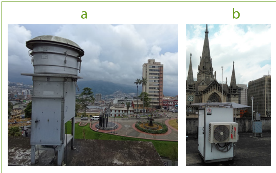
Figura 2. Algunos equipos de monitoreo del SVCA de Manizales. (a) Estación Liceo - Equipo manual Hi-Vol PM_{10} . (b) Estación Gobernación - Equipos automáticos, cabina de gases ( O_3 , SO_2 y CO ) y nefelómetro ( PM_{10} y PM_{2.5} )
