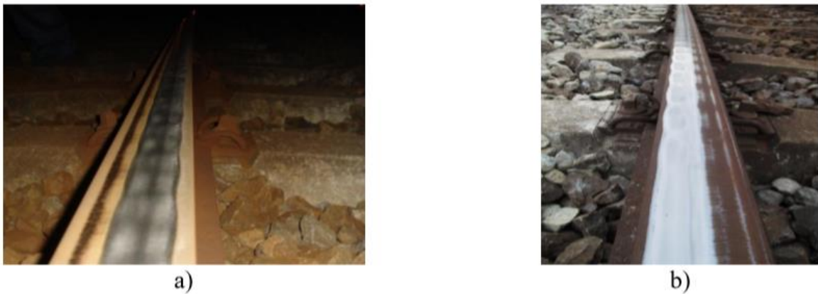
Figura 2-19: a) Desgaste ondulatorio curva 1, b) Desgaste ondulatorio curva 3 [40]. Metro de Medellín.
