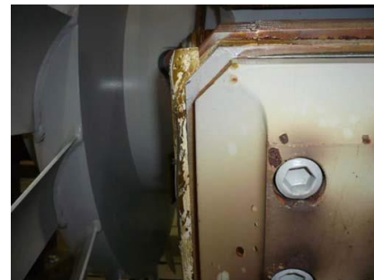
b) Fuga a tierra por envejecimiento térmico de resina
