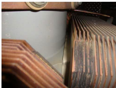
a) Fuga a tierra por suciedad
