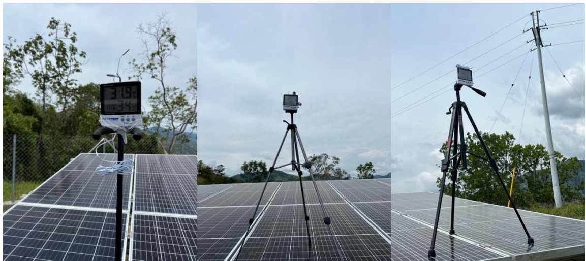
Figura 16. Termohigrómetros ubicados sobre paneles
