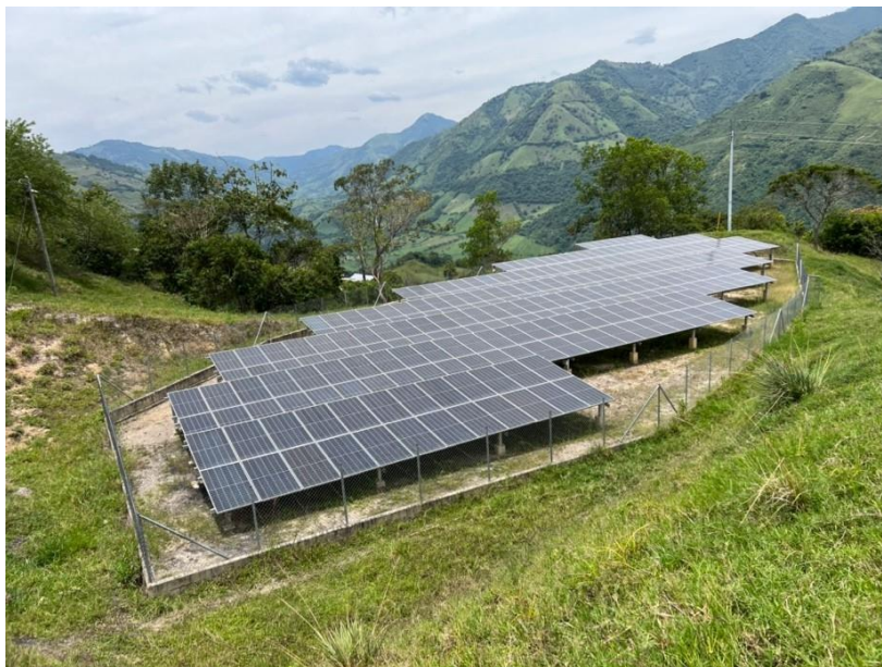
Figura 2. Paneles solares Mina la Margarita (imagen propia)
