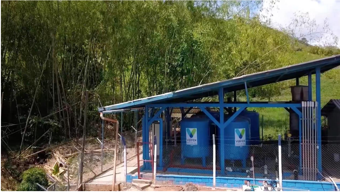
Figura 5. Vista de los seis (6) filtros de la PTAP, San Antonio
