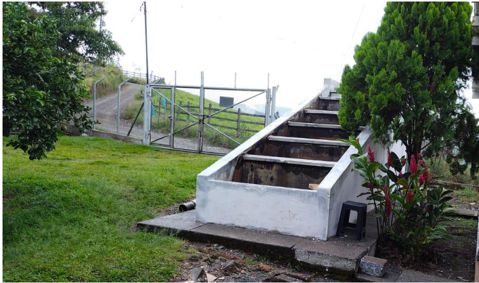
Figura 14. Placas aireadoras del agua cruda
