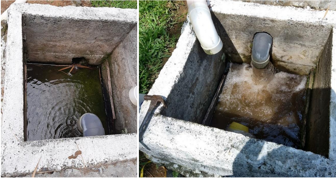
Figura 28. Cámara de aforo y medición de caudal en la cámara
