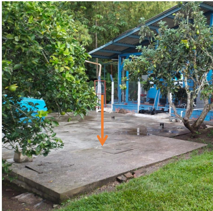
Figura 17. Tanque de almacenamiento de agua cruda (flecha de color naranja)
