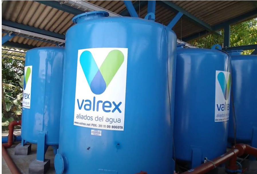
Figura 16. Sistema de filtración
