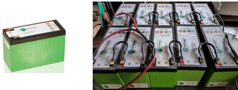
Figura 48. Banco de baterías de la microrred DC experimental. Marca K2 Energy
