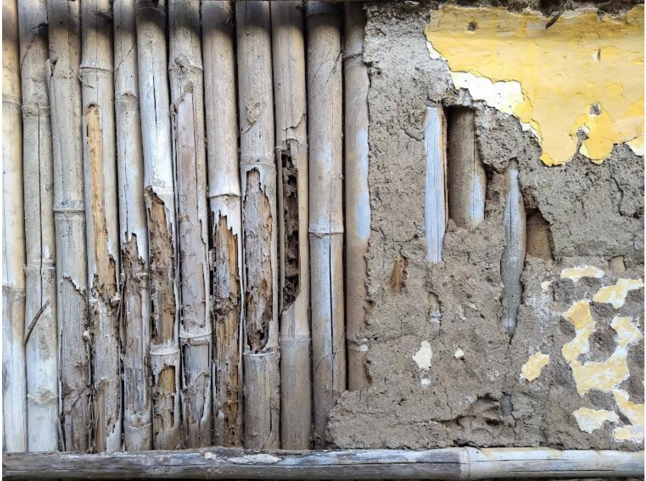
Figura 3-21: Lesión generalizada del cercado por pudrición por humedad, presencia de xilófagos, desprendimiento y erosión del revoque de tierra.
