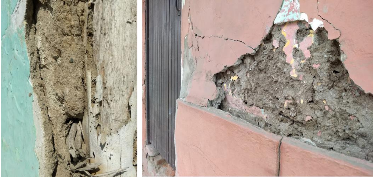
Figura 3-23. Lesión en el relleno por desprendimiento (derecha). Lesión en el relleno por fisuras, grietas y la falta de adherencia entre el relleno de tierra y revoque de cemento y arena sobrepuesto. Fuente: fotografía propiedad del autor (2022).
