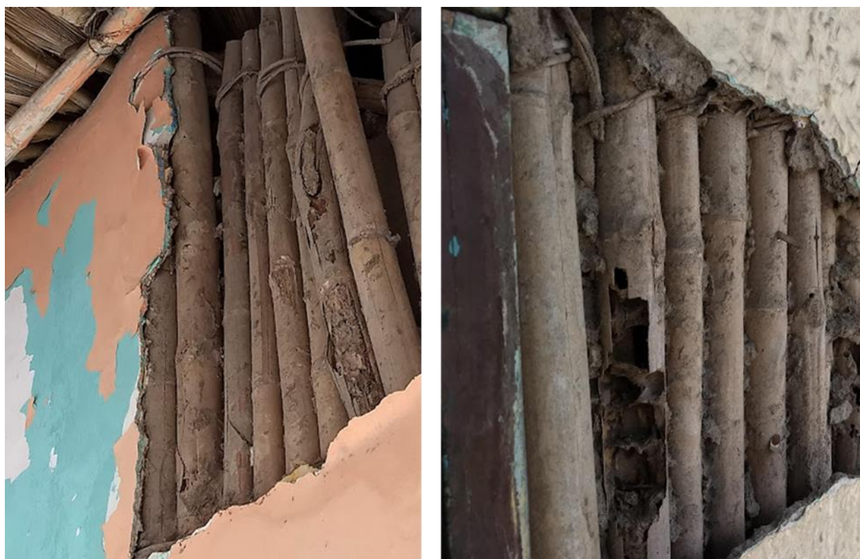
Figura 3-20: Lesión en cerco por desamarre (izquierda), lesión por presencia de xilófagos (derecha).
