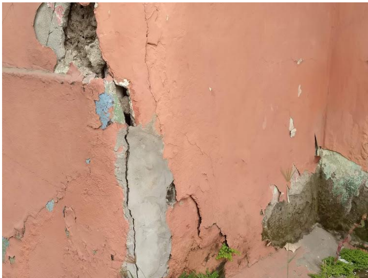
Figura 3-25: Lesión generalizada del acabado final por fisuras, grietas, desprendimiento de pintura, humedad e invasión vegetal.
