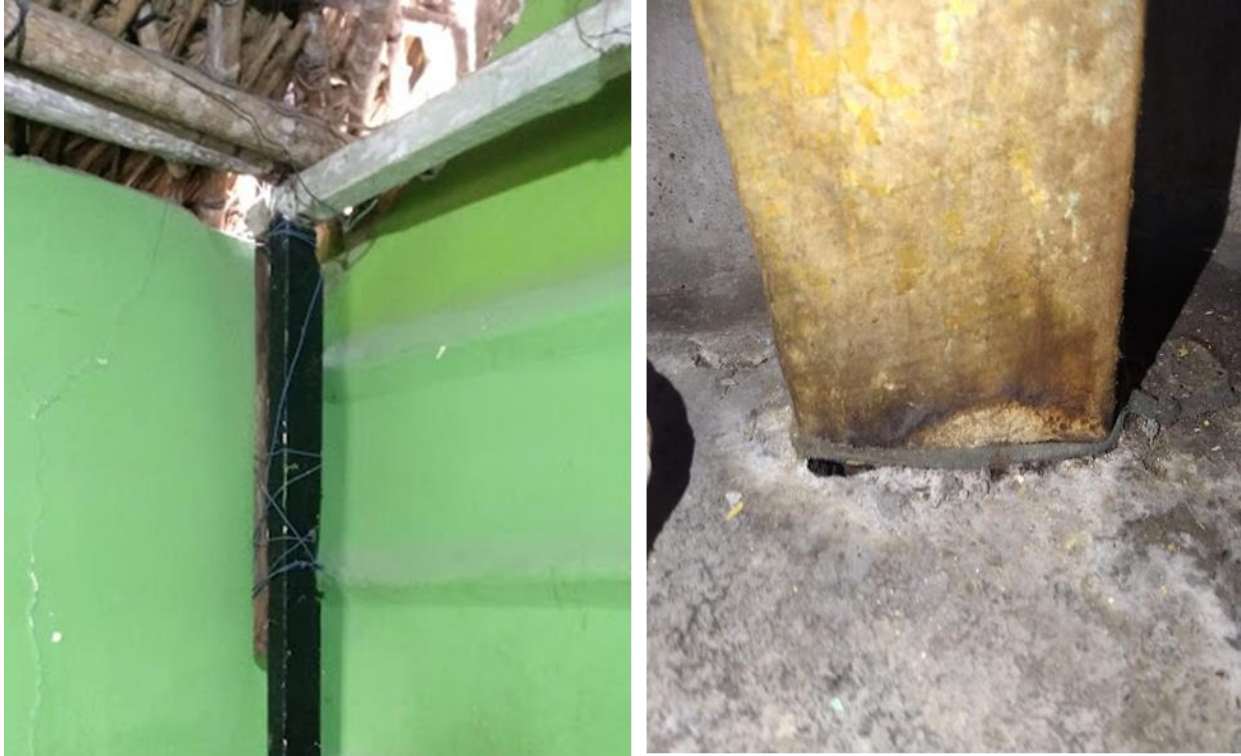
Figura 3-18: Lesión en horconadura por rotura parte superior (izquierda), parte inferior (izquierda). Fuente: Fotografía propiedad del autor (2022).
