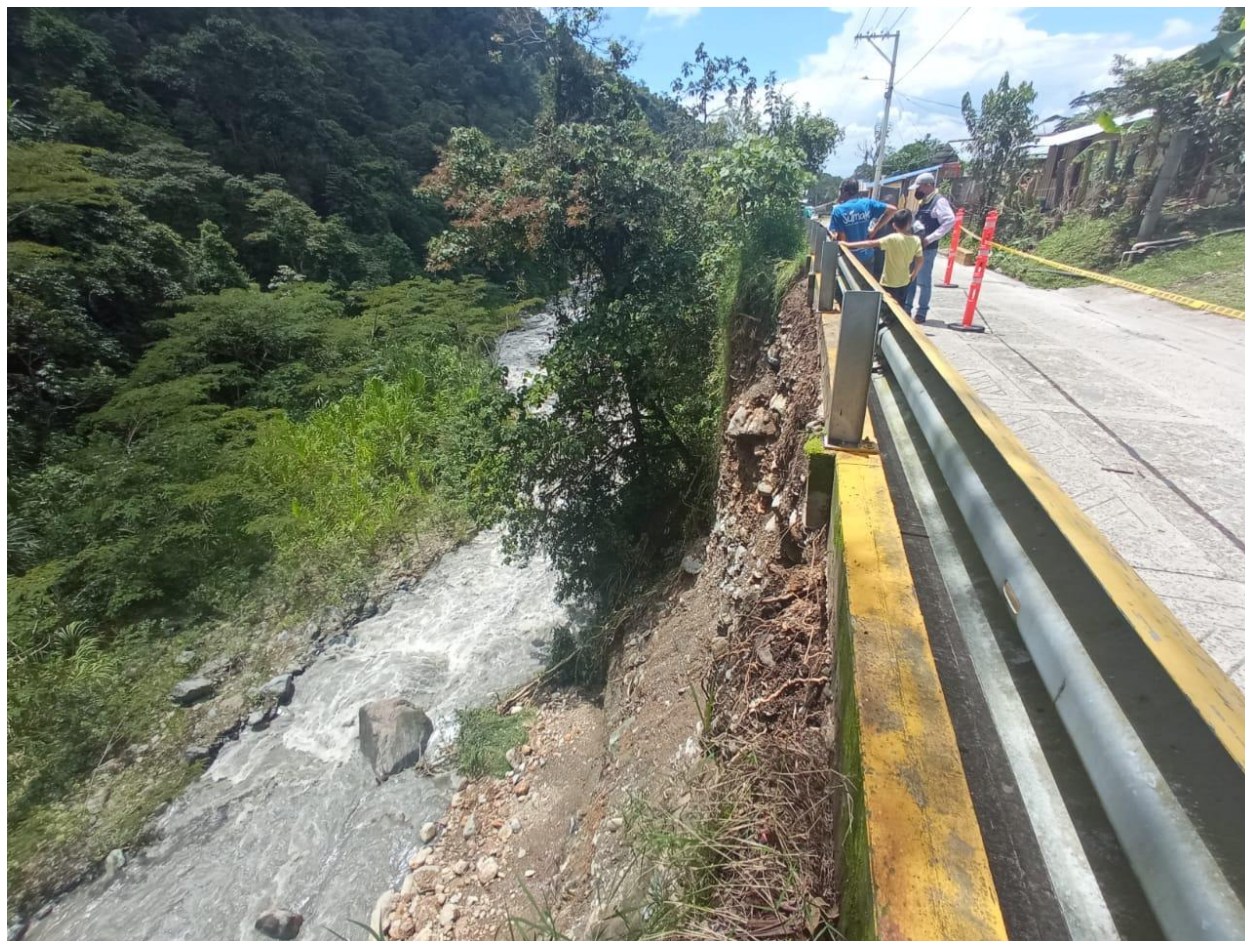
Figura 51 Puente, corregimiento Tenjo, Cauce Nima, condición de riesgo por socavación lateral y arrastre fluvial.
