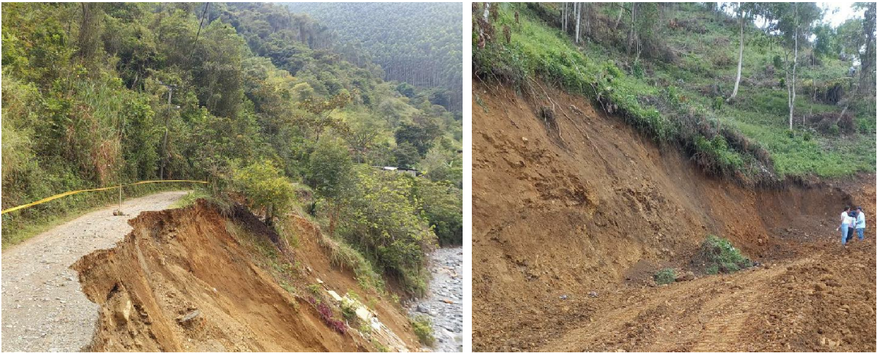
Figura 21 Izquierda deslizamiento y pérdida de banca, corregimiento de Tenjo derecha talud corte de carretera, sector el Mesón.
