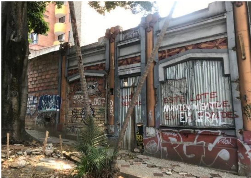
Ilustración 15 Fachada degradada. Carrera 46 # 60 - 12. Fotografía tomada por el autor (2023)
