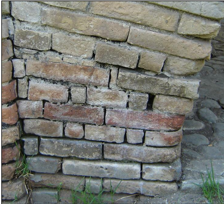
Ilustración 5. Desgaste de morteros en el puente de El Humilladero, en Popayán
