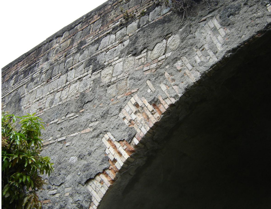
Ilustración 19. Sitio de extracción de muestras de mortero de revoque del puente sobre el río Cauca, en Popayán.
