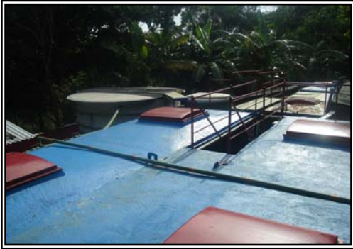
Foto 7. Planta de lodos activados en el Hotel Sol Caribe Campo.
