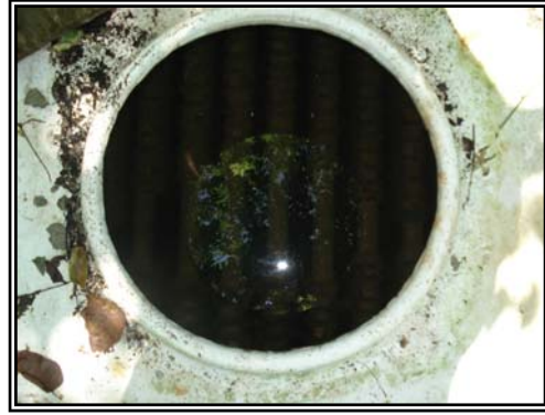
Foto 3. Placas de filtro biológico ECOPAC.
