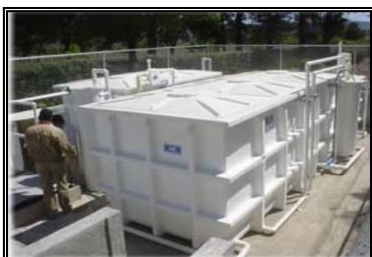
Foto 1. Sistema ECOPAC doble cámara en superficie. Fuente TECO.LTDA.
