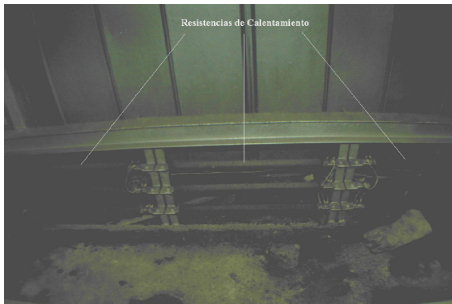
Figura 9. Disposición interna de las Resistencias de Calentamiento.
