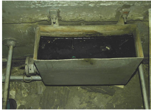
Figura 17. Tanque de vaporización.
