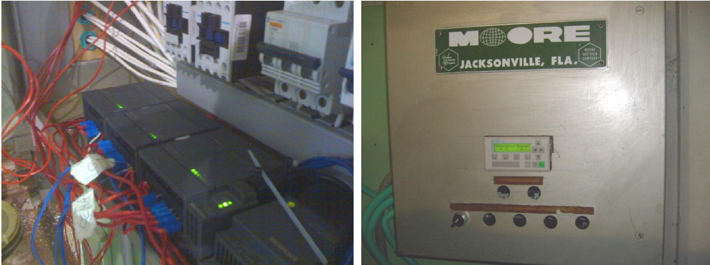
Figura 41. PLC Siemens S7-222 en montaje y Display Táctil en tablero.
