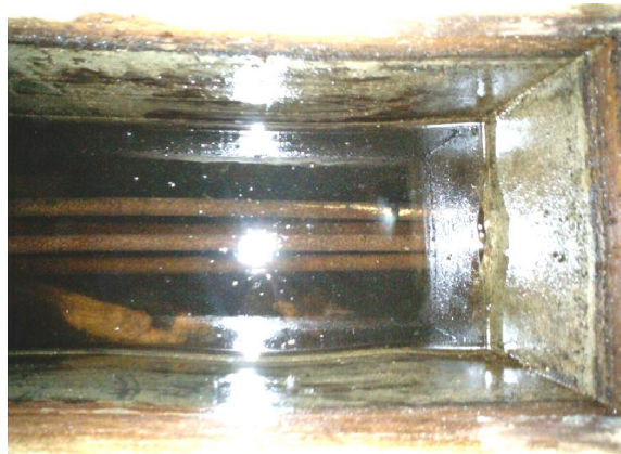
Figura 21. Resistencia de Vaporización en Tanque.
