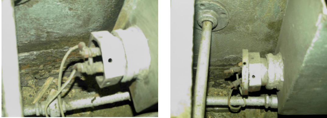
Figura 20. Borneras - Resistencias de Vaporización.
