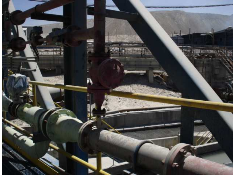
Figura 40. Preparación de Floculante con el uso de Toberas Mina Chuquicamata - Chile
