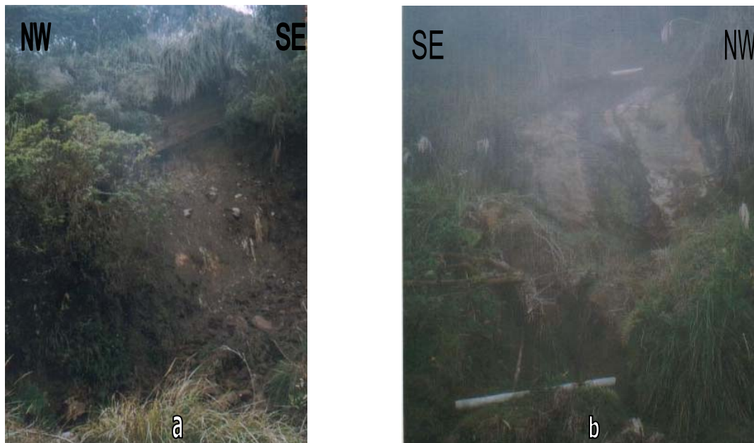
Figura 4. Deslizamiento 1. Rotacional (a) - Caída de roca. Proceso erosivo 4 (b)
