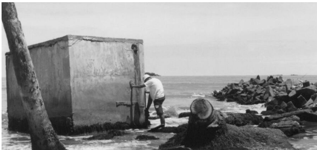
Figura 3. Destrucción de estructuras a causa de la erosión litoral. A la derecha, se observa una serie de pentapodos usados como medida para contrarrestar la pérdida de terreno. Esta imagen corresponde al sitio que antes era la punta de Arboletes
