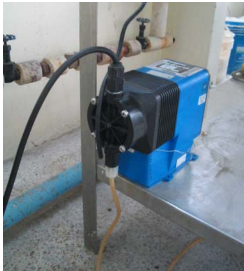
Figura 5. Bomba para Alimentación.
