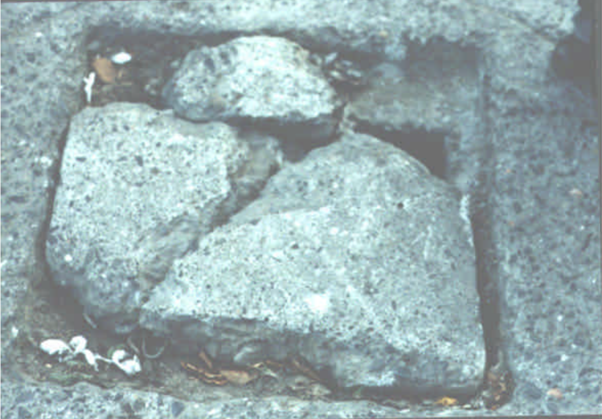
Foto 4.Falla por sobrefuerzo. La tapa presenta el patrón de línea de fluencia apoyada simplemente en todos sus lados, la cual probablemente esta sobreforzada, observándose deficiencias notorias en el anclaje del refuerzo y baja resistencia a la abrasión debido a la poca resistencia del hormigón.
