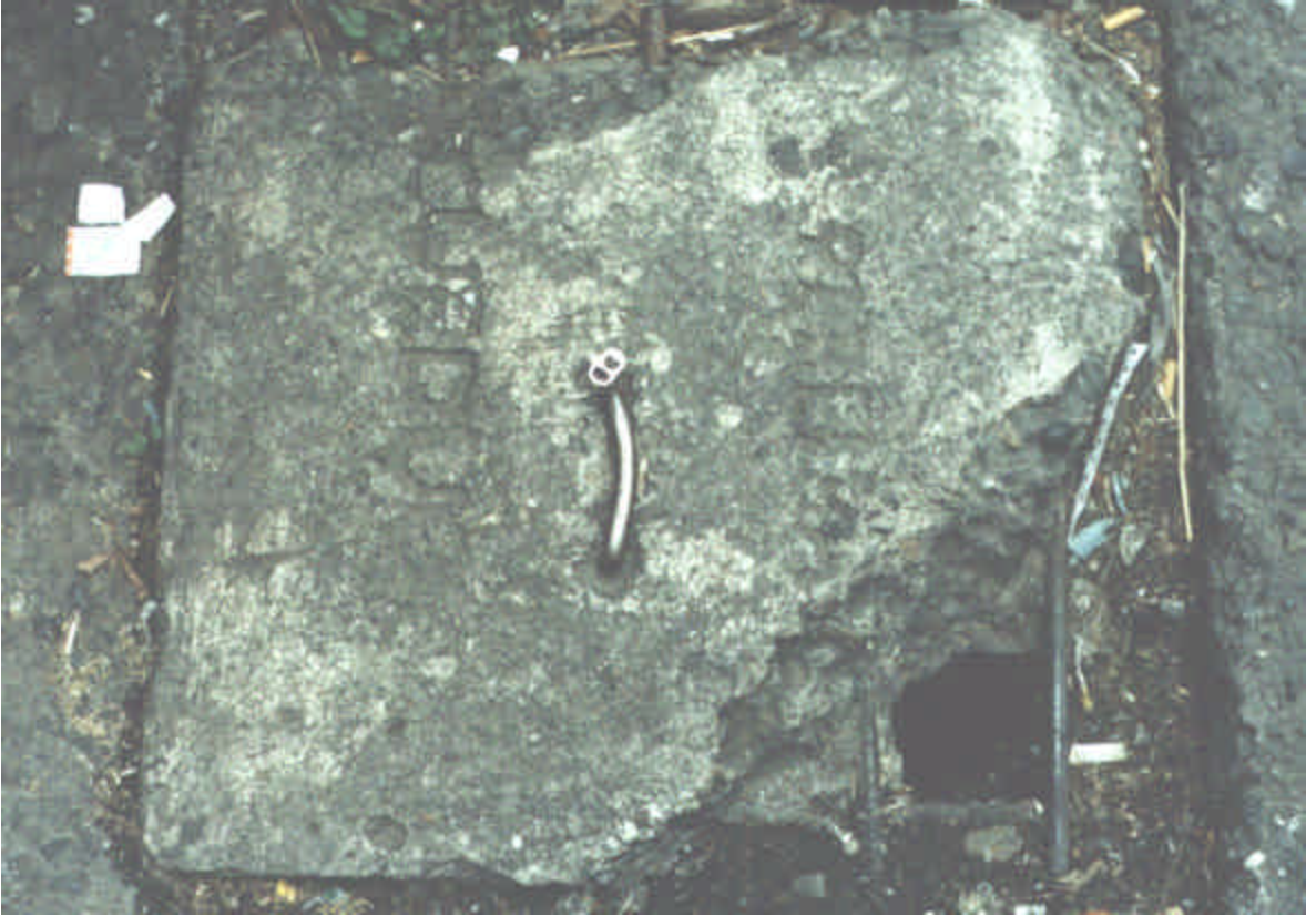
Foto 5. Longitud de anclaje deficiente. Muestra deficiencia en el anclaje, desarrollo de palanca de esquina, y recubrimiento casi superficial en el lado superior de la fotografía.
