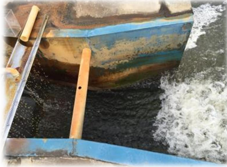
Figura B-1 Punto de resalto hidráulico – canaleta Parshall
