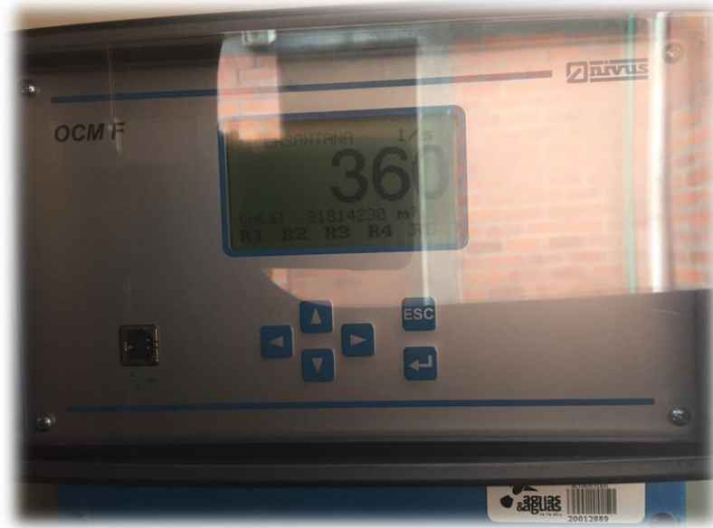
Figura B-5 Medición de caudal con caudalímetro NIVUS
