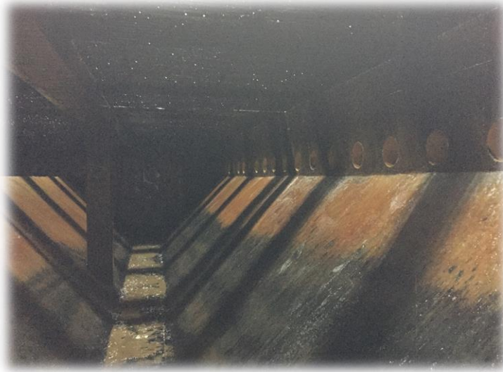
Figura B-3 Tolvas de Sedimentadores
