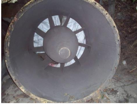
Figura 12. Ventilador principal mina.
