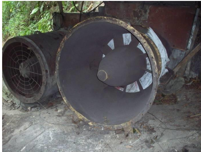
Figura 13. Ventiladores Principales Mina, a la izquierda 40 HP y a la derecha 25 HP.
