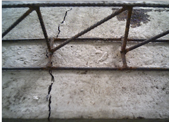
Imagen 18: Forma de falla en el concreto y en la presilla de acero de la vigueta compuesta con conector de cortante.
