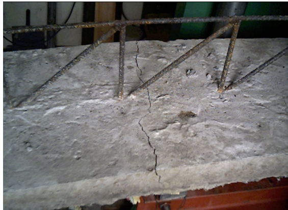
Imagen 15: Forma de falla en el concreto de la vigueta compuesta con el cordón a compresión embebido.
