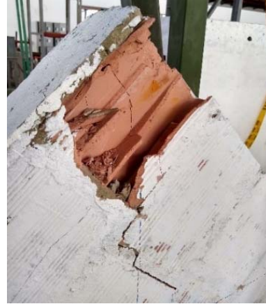
Imagen 24 Ensayo tensión diagonal 4. Fuente (Propia)
