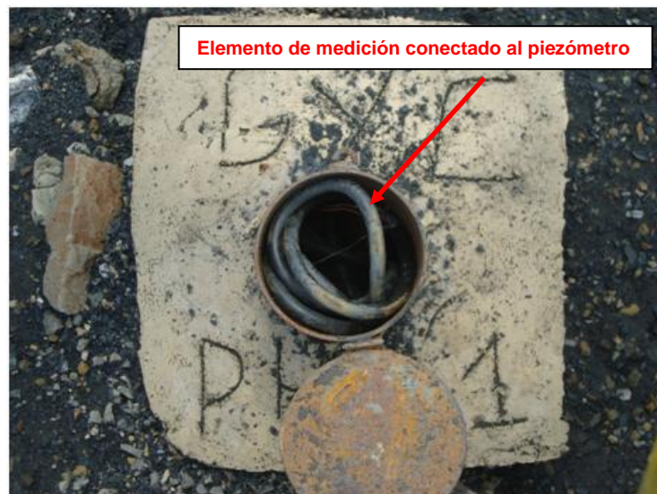
Fotografía 28. Piezómetros de hilo vibrátil para medir presiones de poros y nivel freático. (Foto: 2010).
