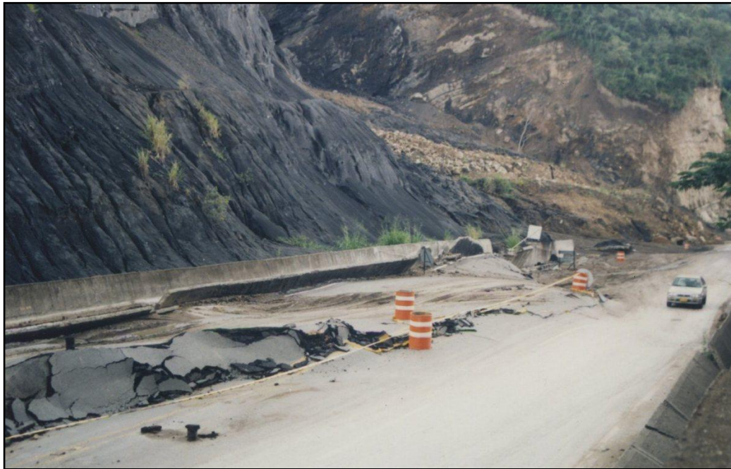
Fotografía 32. Vista del talud occidental y levantamiento de la calzada. Nótese el proceso de flujo en el costado norte Foto C.Palomino S. año 2000.
