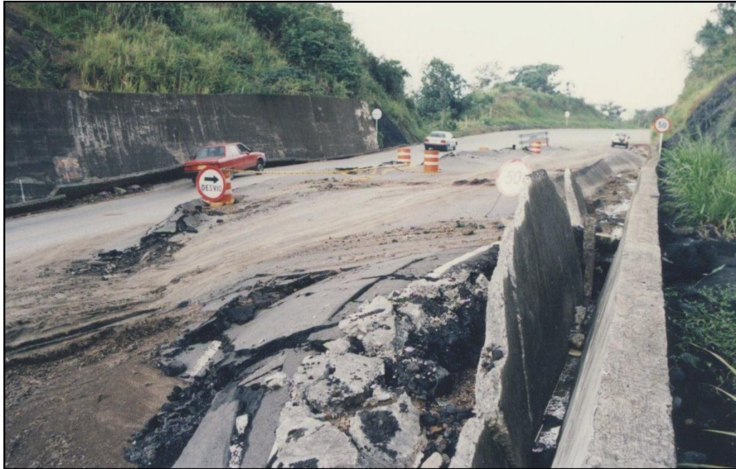
Fotografía 33. Vista de la calzada, hacia el sur. Nótase el levantamiento y afectación de las estructuras de drenaje y contención de la vía. Foto C.Palomino S. año 2000.
