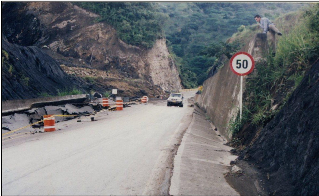
Fotografía 31. Levantamiento fuerte de la banca. Foto C.Palomino S. año 2000.
