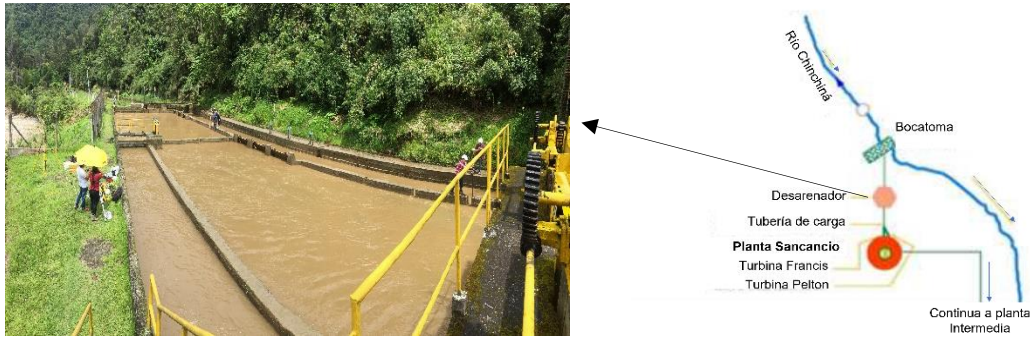
Figura 1: Tanque desarenador Sancancio.
