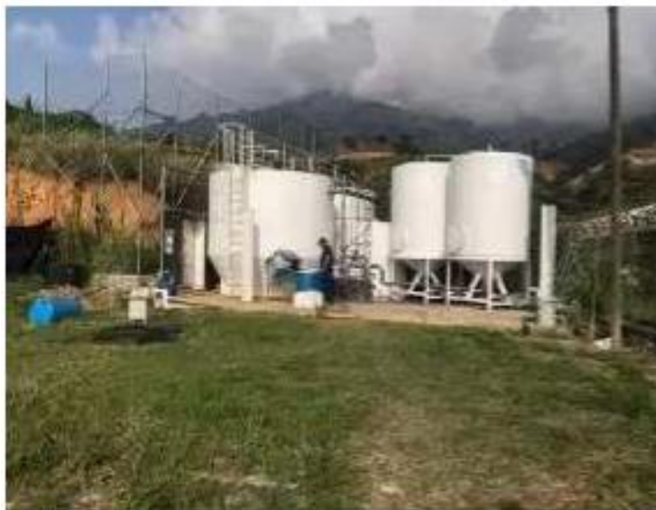
Figura 8. Planta de Tratamiento de Agua Potable N° 1 (PTAP 1)
